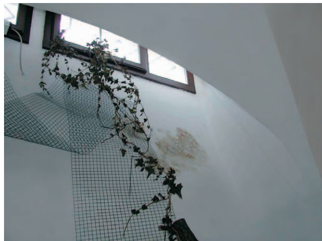
Obr. 3: V místech s menší tloušťkou je odolnost sanační omítky nedostatečná. Kondenzát stékající z okna dokáže rychle zaplnit její póry vodou a soli snadno proniknou na povrch.
