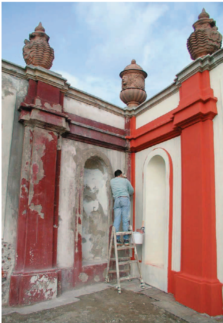
Obr. 1: Pokud je oprava zasolených podkladů časově rozdělena, musí být řešeno i napojení jednotlivých úseků. V daném případě bude nutné celý kout ohradní zdi omítnout znovu sanační omítkou.
