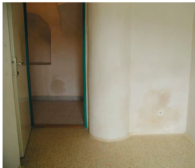
Obr. 5: Hygroskopické mapy znehodnotily sanační omítku v okolí sádrových terčů pro uchycení elektroinstalací
